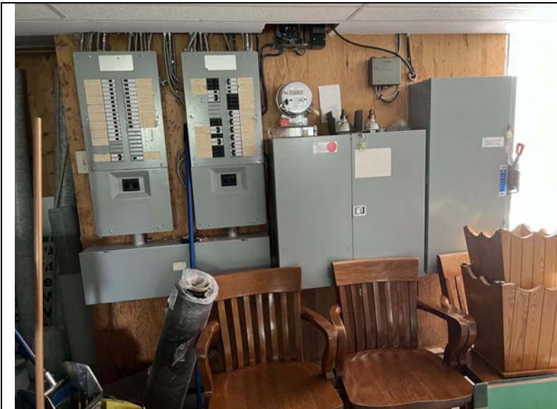
Sous-sol de la sacristie – entrée électrique 400A
