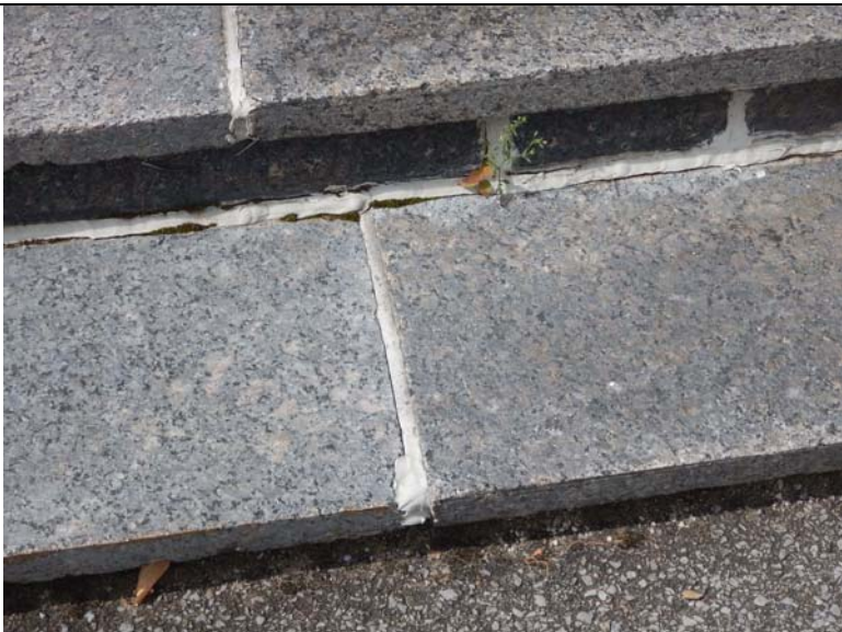
Le scellant des joints du dallage du perron est obsolète et doit être refait
