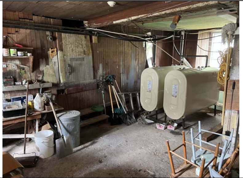
Sous-sol de la sacristie – atelier et réservoirs d'huile
