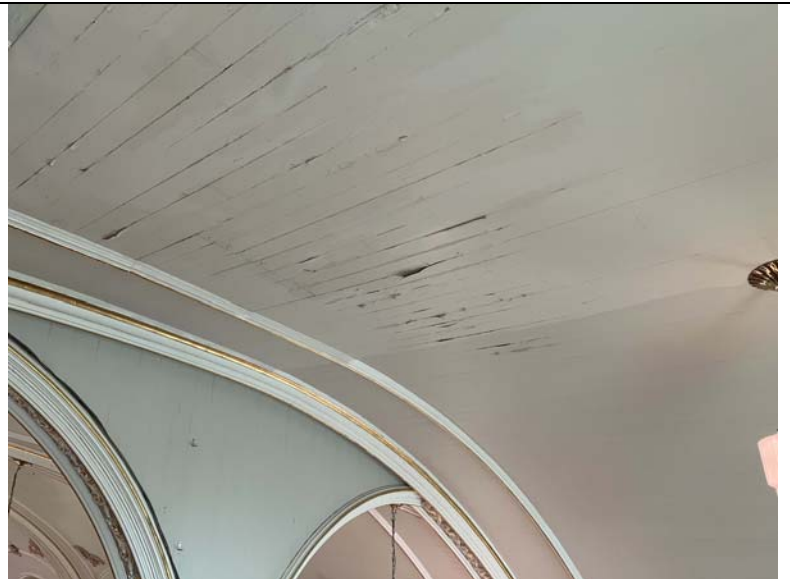
Peinture décollée suite à d'anciennes infiltrations d'eau provenant du clocher
